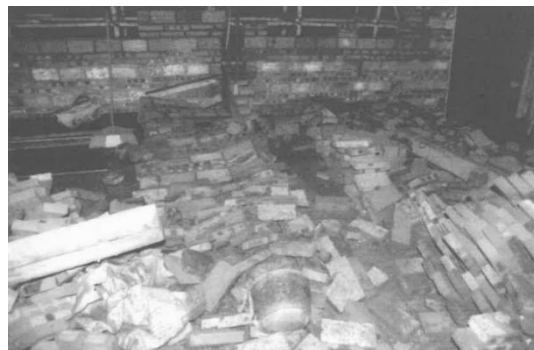
二楼楼顶东侧的墙体倒塌
