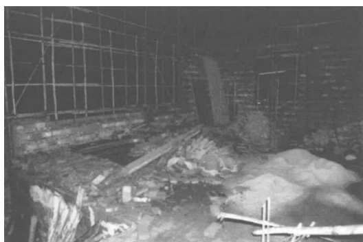
二楼楼顶东侧的墙体倒塌
