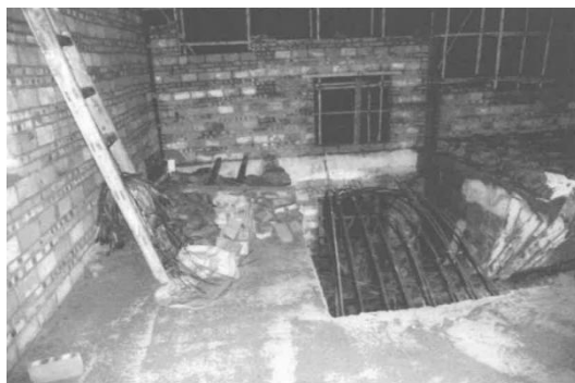
二楼楼顶楼梯处东、西侧的墙体倒塌
