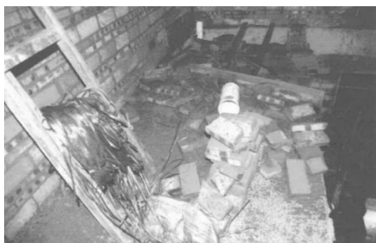
二楼楼顶西侧的墙体倒塌
