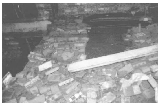
二楼楼顶东侧的墙体倒塌
