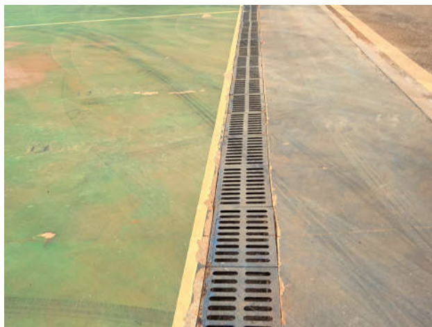
图 18 升压站场内排水
