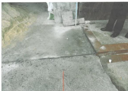
蔡胜在建楼房水泥地上遗留的1颗膨胀螺栓
