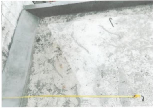
蔡胜在建楼房一楼楼顶上遗留的固定孔
